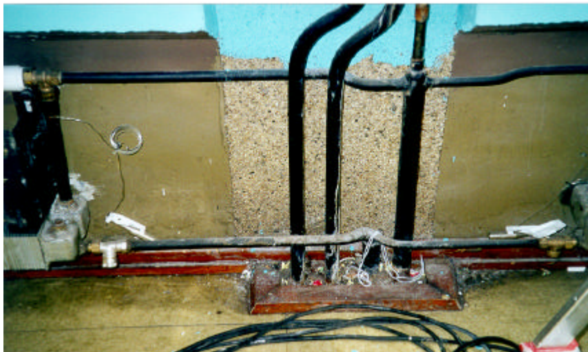
Hinter den Heizkörperverkleidungen sammelte sich der Schmutz und Staub
