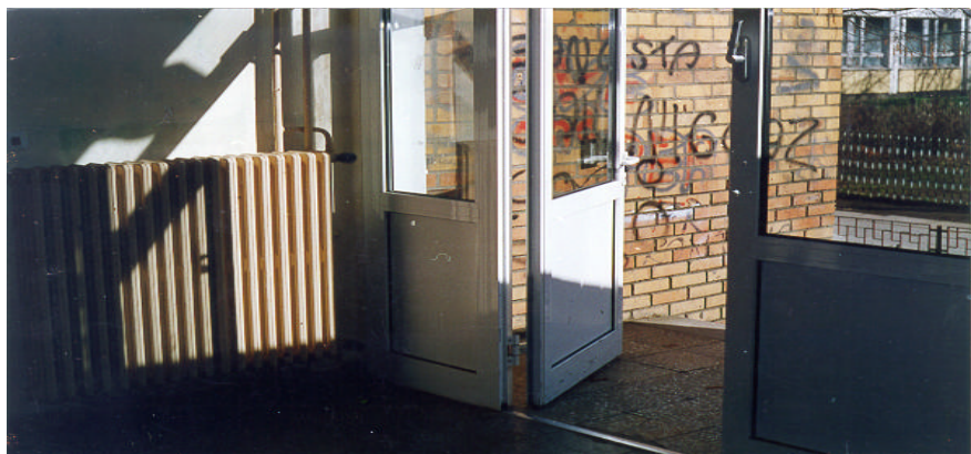
Abb 1: Hier wird der Schulhof geheizt. Gesamtschule Lützen-Klein, Rorbach
